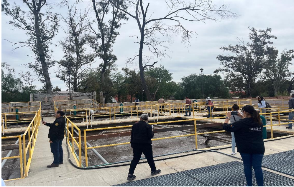
Ilustración 2. Tanques de aireación.
