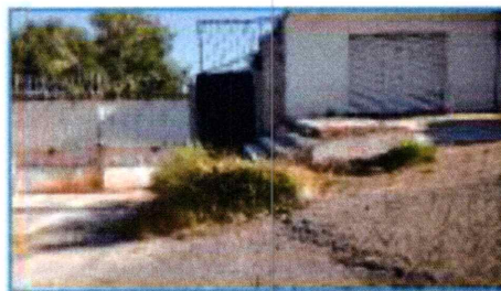
Punto GPS10, se observa desnivel en calle Francisco villa
