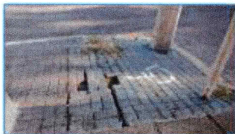
Punto GPS01 desnivel y separación de adoquín
