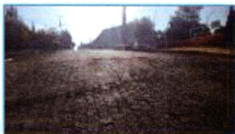
Desnivel en calle Francisco villa
